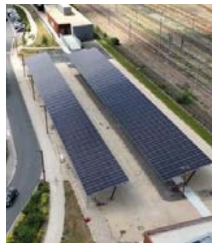
Les ombrières de la Station T
