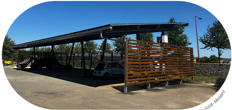
Ombrière photovoltaïque avec bardage bois, ateliers municipaux, Saint-Martin-de-Saint-Maixent
