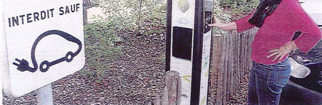
Bressuire, hier. Une des premières des 130 bornes prévues par Séolis en Deux-Sèvres, installée Place Saint-Jacques.
